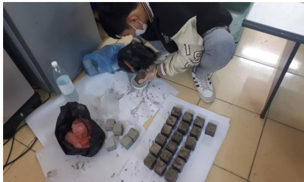
Hình 5. Quá trình quét sơn chống thấm và chuẩn bị mẫu thí nghiệm.
